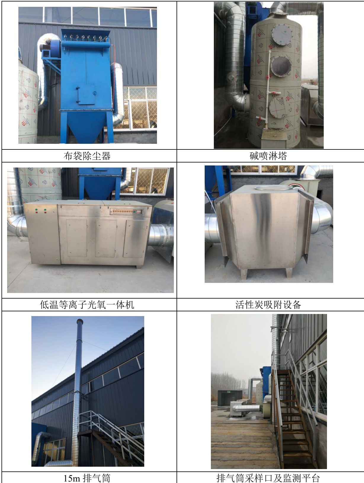
图 4-1 废气环保设施现场照片
