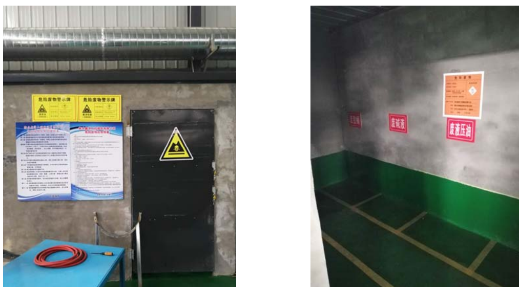
图 4-3 危废暂存间现场照片
